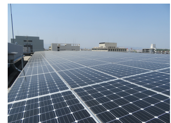
加島事業所オフィス棟屋上の太陽光パネル
